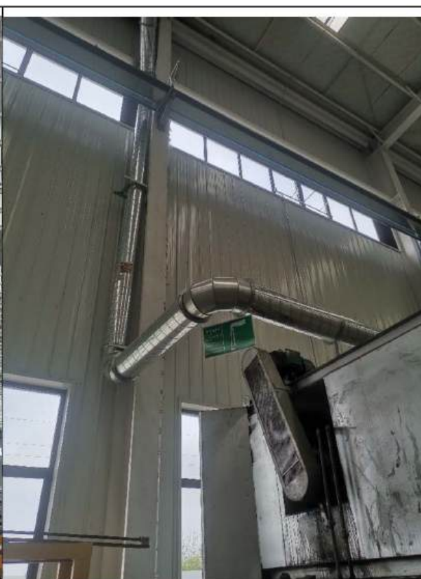
4#时效炉废气排气筒 (Q16)
