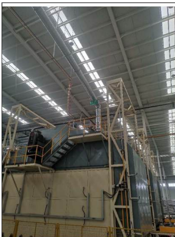
1#-3#时效炉废气排气筒 (Q8)
