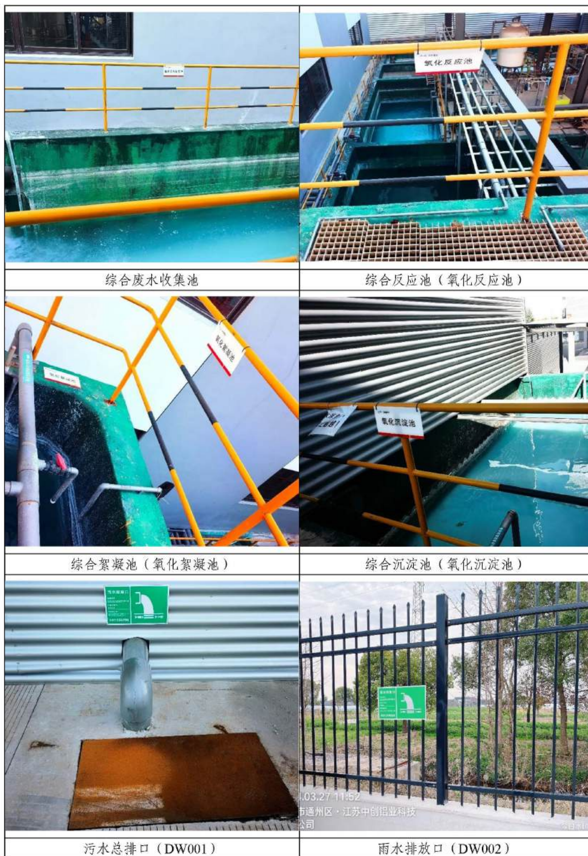
图 4.1.2-3 污水处理设施现场照片
