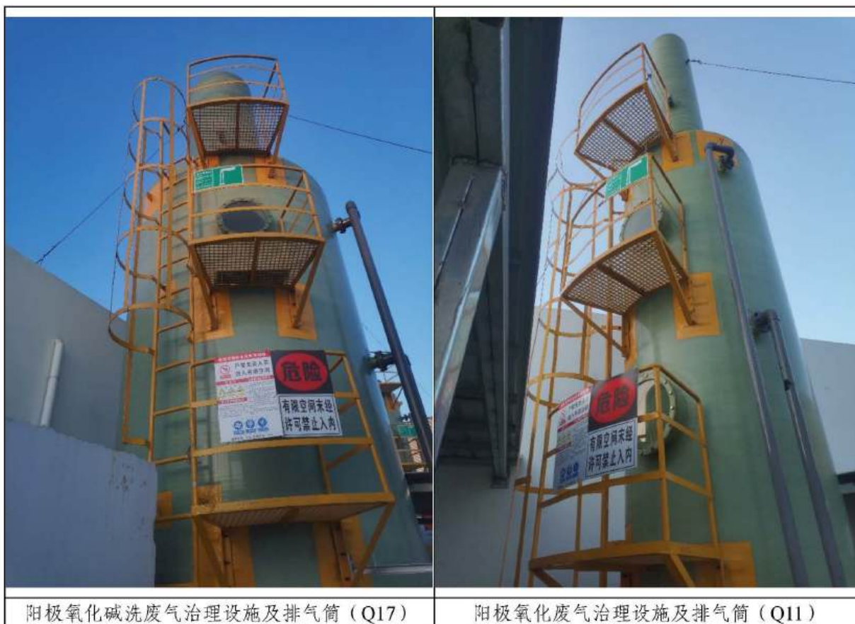
图 4.2.2 废气污染防治设施现场照片
