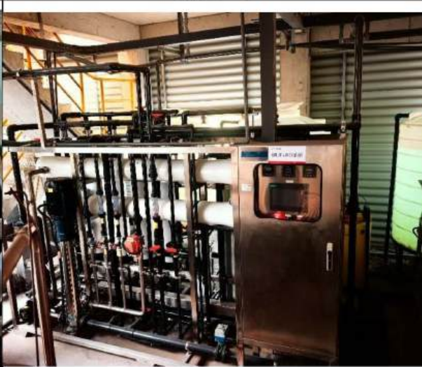
含镍废水 UF+RO 系统
