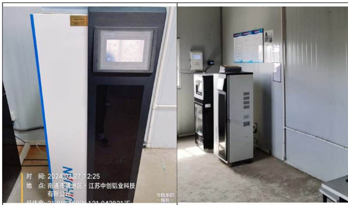
图 4.6 废水在线监控设施
