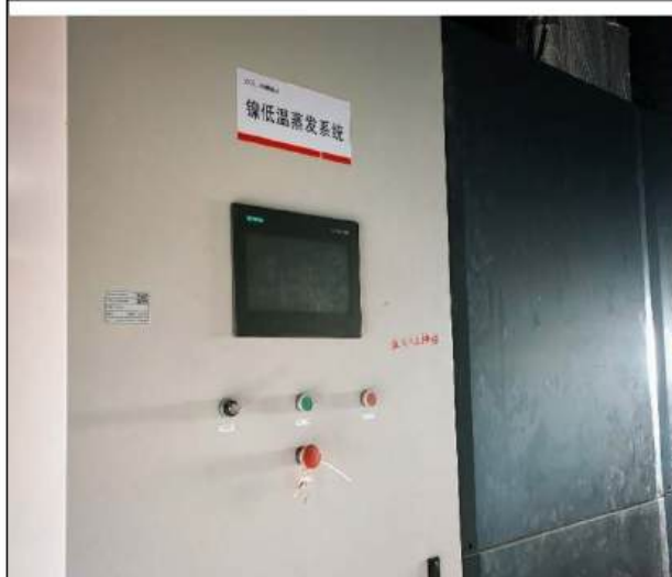
含镍废水蒸发结晶系统
