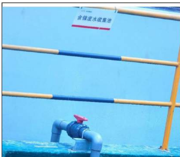
含镍废水收集池
