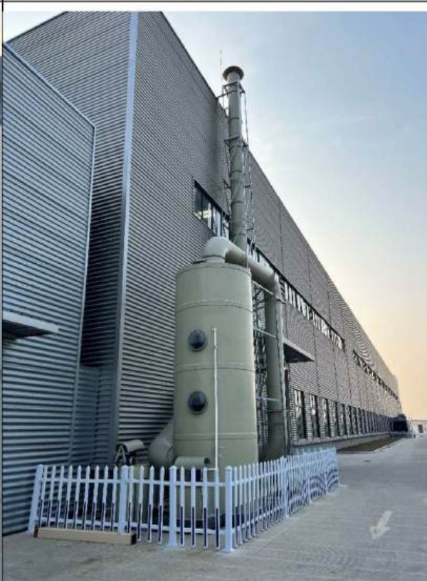
模具碱洗废气治理设施及排气筒 (Q10)
